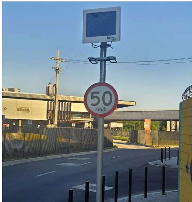
Figura 38. Lombada eletrônica instalada
